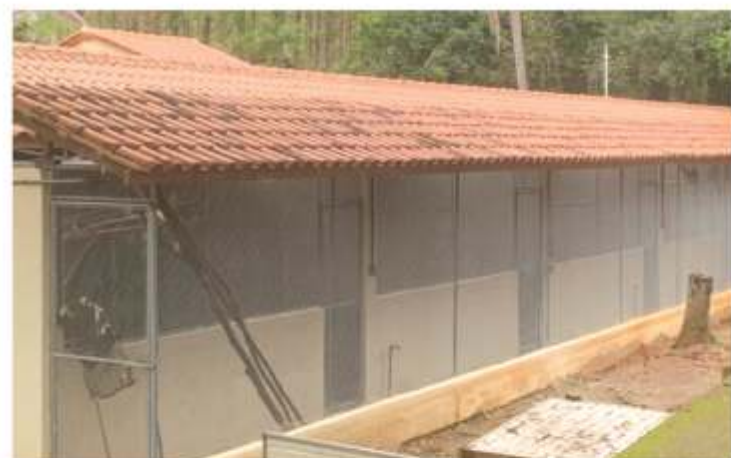
Depois da paralisação por suspeita de gripe aviária no ano passado, agora a alegação é problemas estruturais
